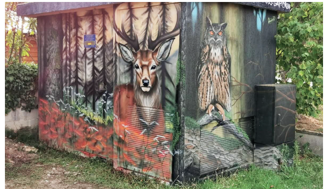
Graff sur le transformateur des Bordes Mai 2025
